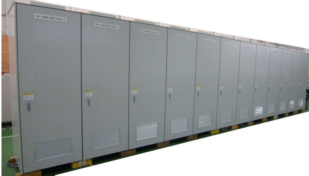
The Turbine Control System for export thermal power (EHG盤3面 + TPC盤4面 + ATS盤4面 + MODBUS盤1面)
